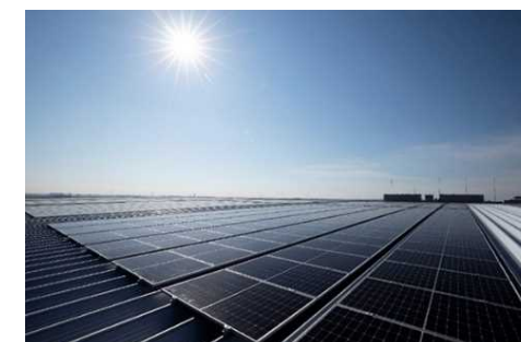
屋上太陽光パネル
